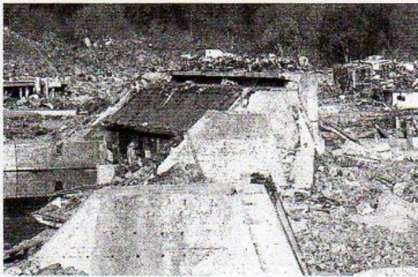
東日本大震災の津波で壊れた水門。両側にあった防潮堤は津波で流され、基礎だけが残っている。2011年4月、岩手県宮古市
